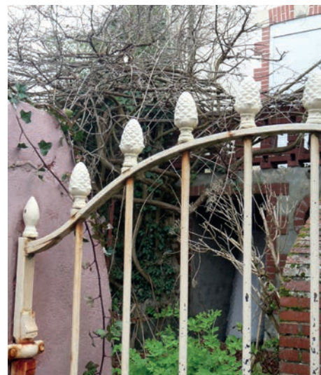
La restauration de cet élément (rouille, peinture écaillée) permettra de conserver ce portail aux épis en forme de pomme de pin.
