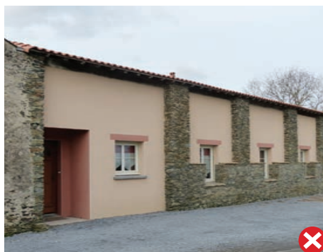
Le remplissage maçonné des ouvertures et l'intégration de menuiseries standardisées sont dommageables au projet.
