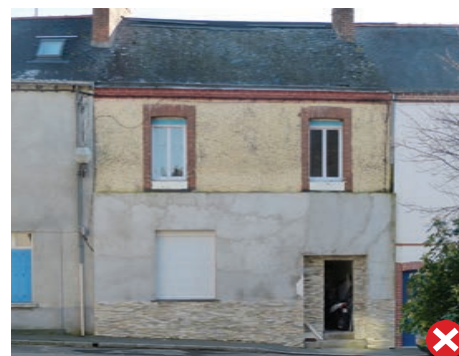
Disparition des proportions des baies du rez-de-chaussée, enduit-ciment et placage en fausses pierres inadéquats.
