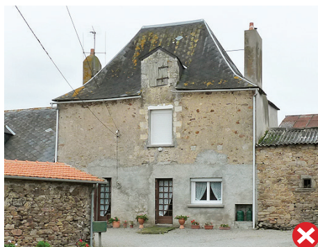
Les ouvertures modifiées, l'emploi du PVC et de l'enduit-ciment sur cette ferme manoir ont appauvri ce patrimoine.
