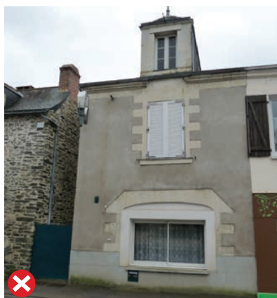
Les modénatures ont été conservées, mais le choix de la menuiserie dénature la façade. Le remplissage béton pour accueillir la nouvelle menuiserie nie l'ouverture d'origine.
