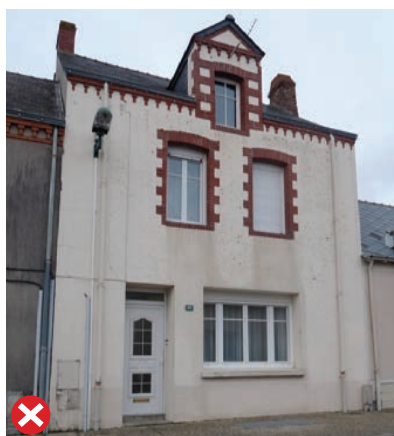
L'ouverture du rez-de-chaussée plus large que haute défigure la façade de la maison. L'emploi du PVC pour les menuiseries nuit à la façade.
