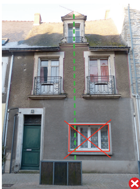
La fenêtre plus large que haute, l'enduit-ciment, dénature cette façade de maison de ville.
