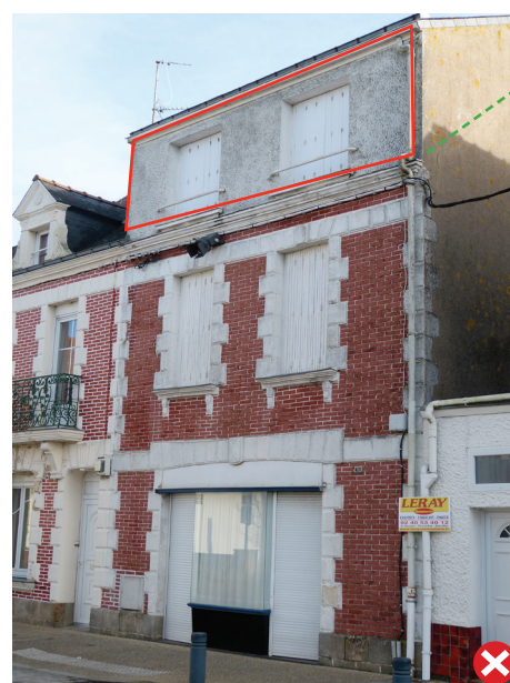
La surélévation est ici préjudiciable à la maison (effet de caisson et proportion des baies).
