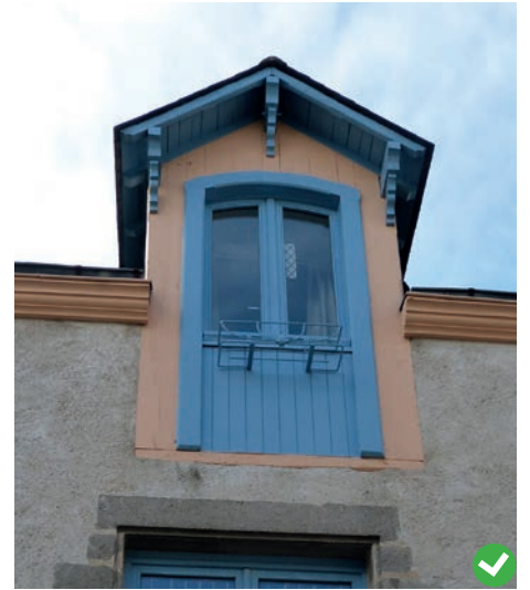
L'écriture de la cette lucarne gerbière avec son remplissage bois pour l'allège du percement permet la protection contre le franchissement.
